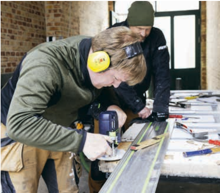
Snedker Simon Damkjær (forrest) og Tomas Vesti fra Kastrup Bygningssnedkeri i fuld gang med renoveringen af den næsten 100 år gamle port.
